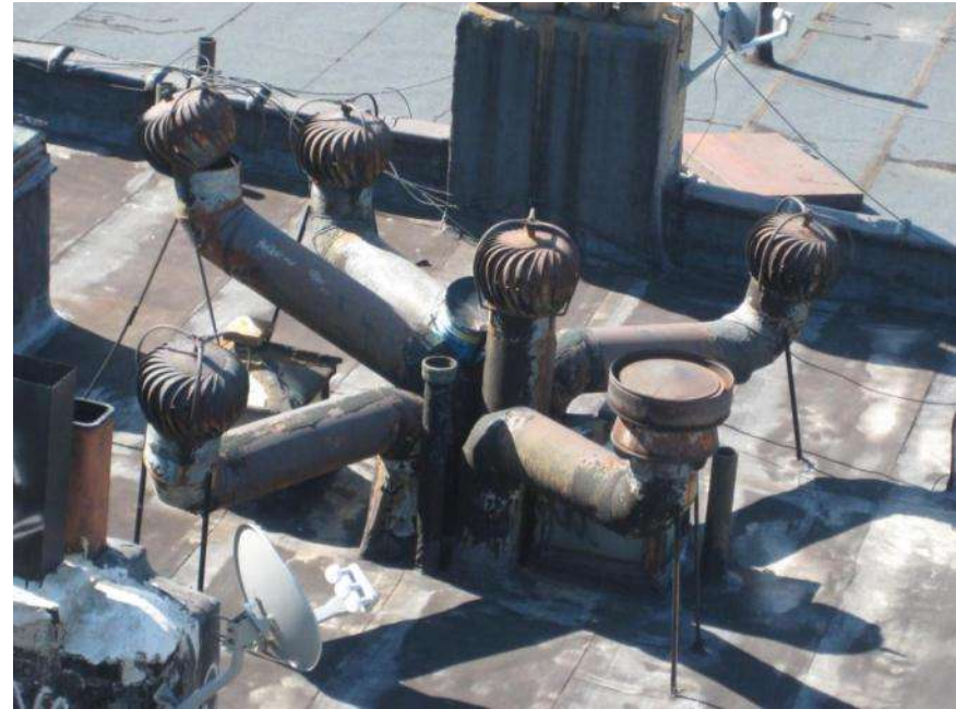
Rooftop Fan "Art"
